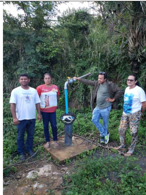
Foto 12: Poço da Cerb localizado na serra do Morgado. Atende ao Sistema de abastecimento de Juacema e adjacências. Perfurado no leito do riacho da cachoeira. Água vai pra caixa de 100 mil litros para ser distribuída.
