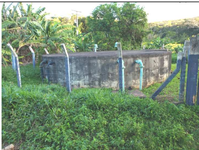
Foto 15. Caixa d'água de 100 mil litros na serra dos Morgados do sistema de abastecimento de água de Juacema e adjacências.
