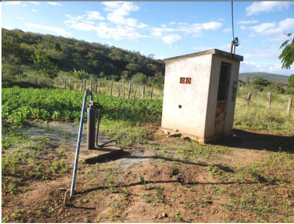
Foto 30. Poço tubular perfurado pela Cerb em funcionamento. Abastece o sistema de Flamengo, Barrinha e adjacências.
