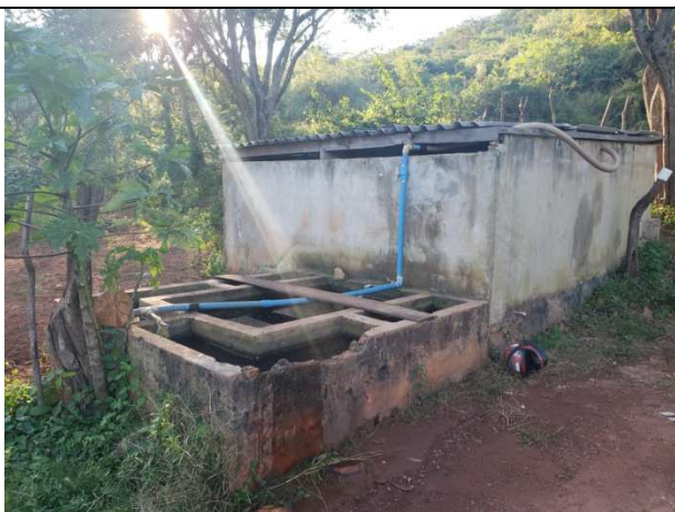
Foto 40: Reservatório de água na faz. de Franco Melo
