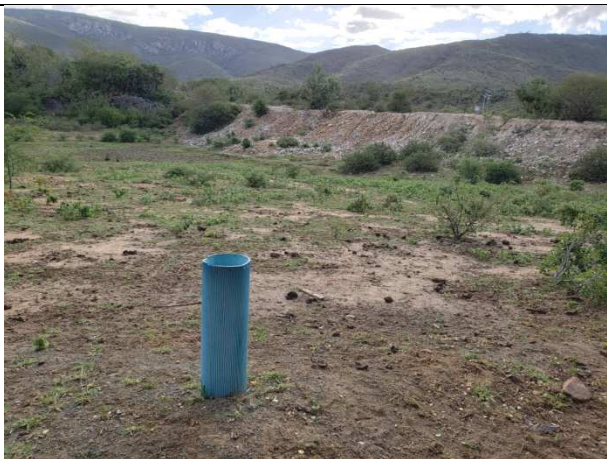
Foto 28. Poço tubular perfurado pela Cerb. Não instalado e sem tampa.
