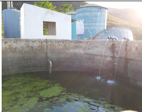
Foto 35. Caixa d'água do Sistema de abastecimento do Flamengo, Barrinha e adjacências, localizado no alto da serra do Morgado.
