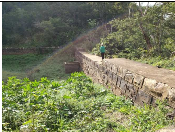
Foto 37. Barramento antigo existente no riacho Cachoeira. No dia da inspeção se encontrava totalmente vazia. Não foi identificado o proprietário. Atribui-se a RFFSA.
