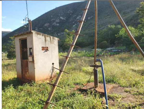
Foto 31. Poço tubular perfurado pela Cerb em funcionamento. Abastece o sistema de Flamengo, Barrinha e adjacências.
