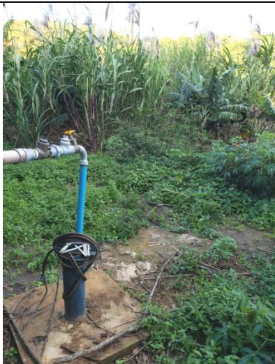
Foto 13: Poço da Cerb localizado na serra do Morgado. Atende ao Sistema de abastecimento de Juacema e adjacências. Perfurado no leito do rio em meio ao plantio de cana. Água vai pra caixa de 100 mil litros para ser distribuída.
