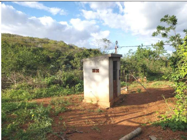
Foto 32. Poço tubular perfurado pela Cerb em funcionamento. Abastece o sistema de Flamengo, Barrinha e adjacências.
