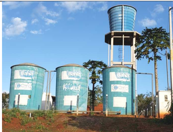
Foto 33. Sistema de abastecimento do Flamengo, Barrinha e adjacências localizado no alto da serra do Morgado.
