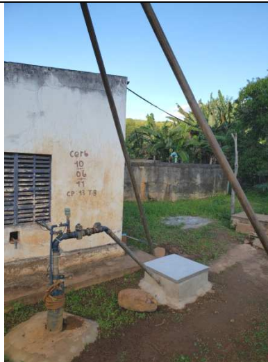
Foto 14: Poço da Cerb localizado na serra do Morgado. Atende ao Sistema de abastecimento do Morgado e adjacências com 120 ligações. Água vai pra caixa de 20 mil litros para ser distribuída.
