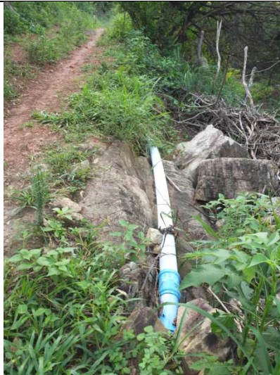
Foto 19: Tubulação de 5 polegadas descendo a serra a qual abastece o povoado de Juacema e adjacências por gravidade através da caixa de 100 mil litros localizada na serra do Morgado.
