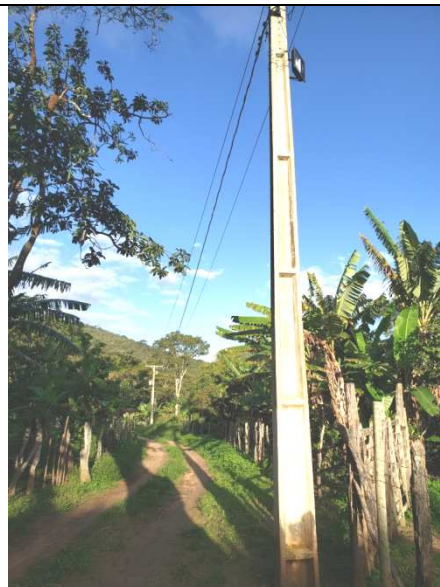
Foto 31: Linha de distribuição de energia rural dos Covões
